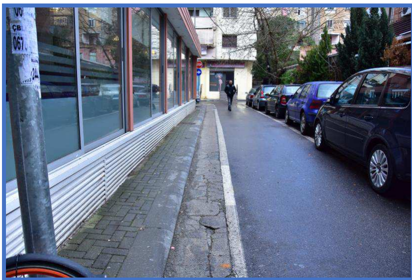
Fig. 1 Verehet një demtim i kunetave anesore të rrugës për shkak të mungesës së kanalizimeve kulluese dhe akumulimit të ujrave të shirave për një kohë të gjatë
