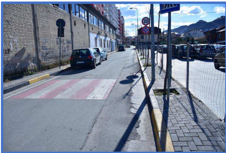
Fig. 3 Trotuaret ne shume raste jane nominale dhe shtresat asfaltike te riparimeve jane shtruar ne menyre te papershtatshme, duke demtuar dhe kunetat anesore te rruges
