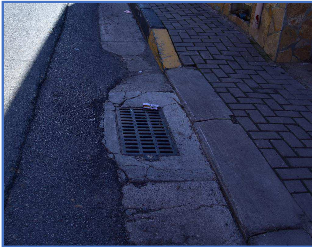
Fig. 4 Riparimet e kryera pas investimit fillestar dhe cilësia e ulet e materialeve e përdorur në ndërtimin e kornizave anësore të rrugës dhe kornizat e pusëve kanë kontribuar në demtimin e këtyre të fundit dhe prishjen e lidhjes mes materialeve të ndryshme përberese të rrugës.
