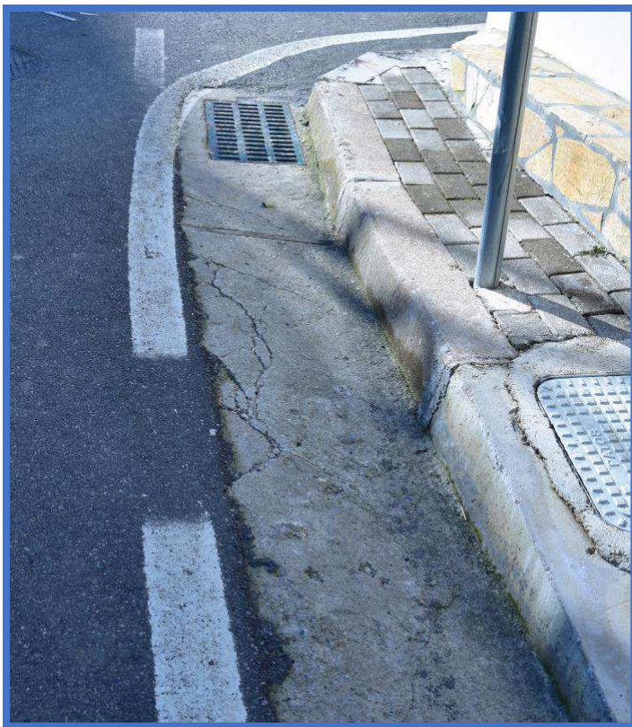
Fig. 2 Kunetat anesore te rruges jane te demtuara per shkak te materialit te dobet te perdorur ne ndertimin e tyre
